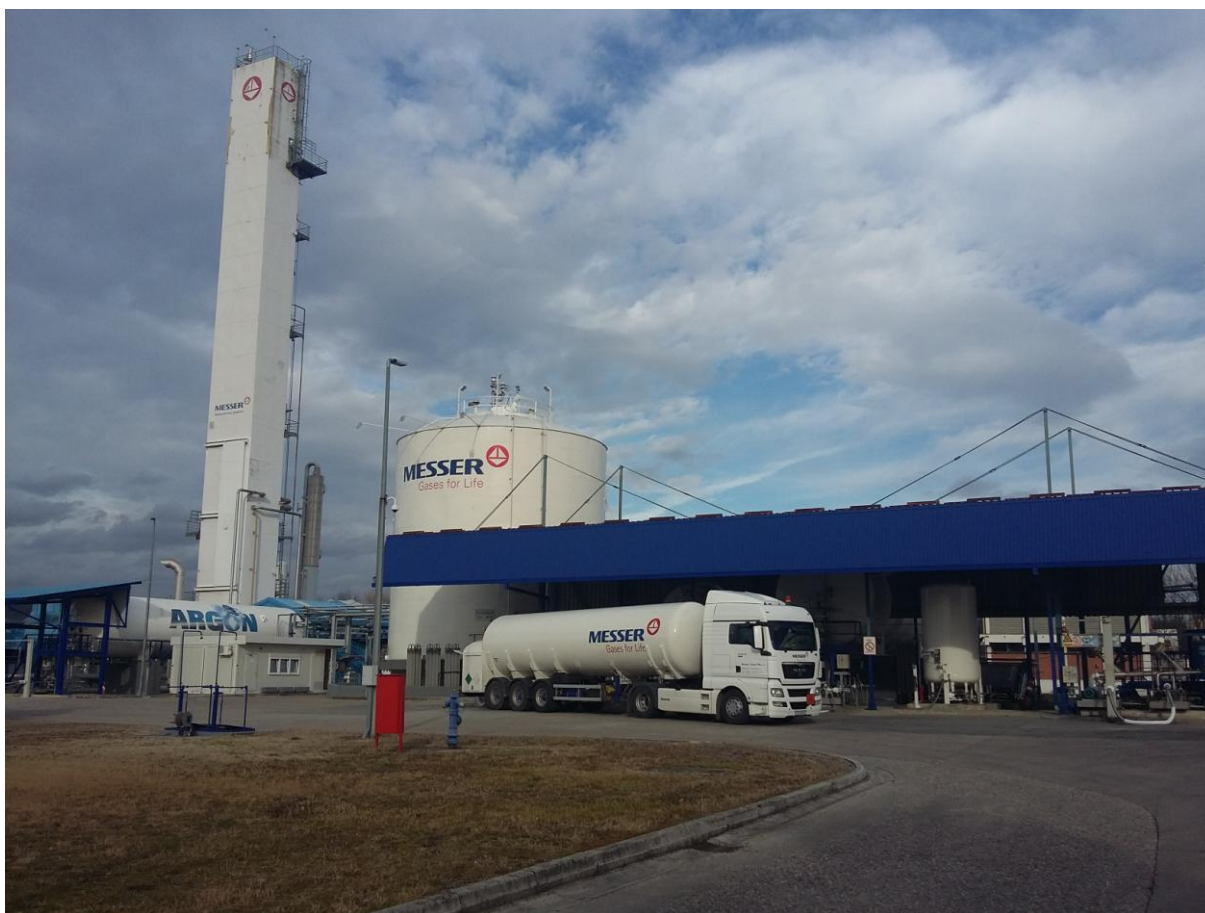
Slika 3: Postrojenje za razlaganje zraka (Kolona za razlaganje zraka). (vlastita fotografija)
